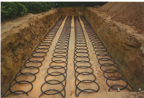
土壌内への敷設事例（ハウス農業空調用）
